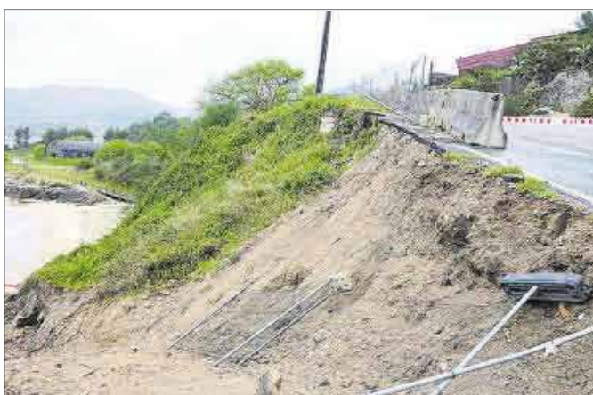
Zona de las obras en el talud derrumbado de O Cocho. // G.N.
